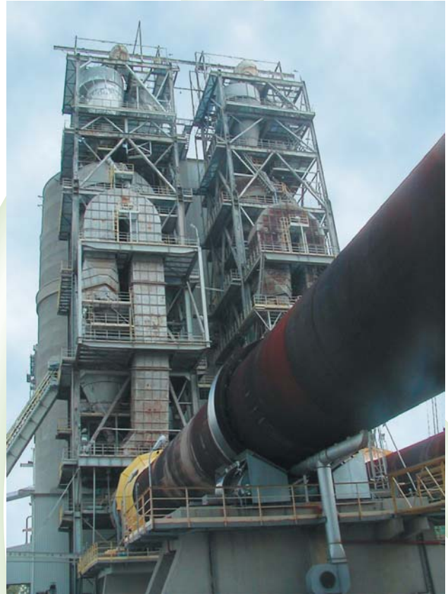
Nowoczesna linia wypału klinkieru – wieża wymienników ciepła i piec.
