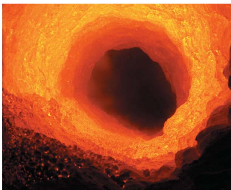
Strefa spiekania w piecu cementowym. Temperatura materiału ok. 1450°C, gazów ok. 2000°C.
