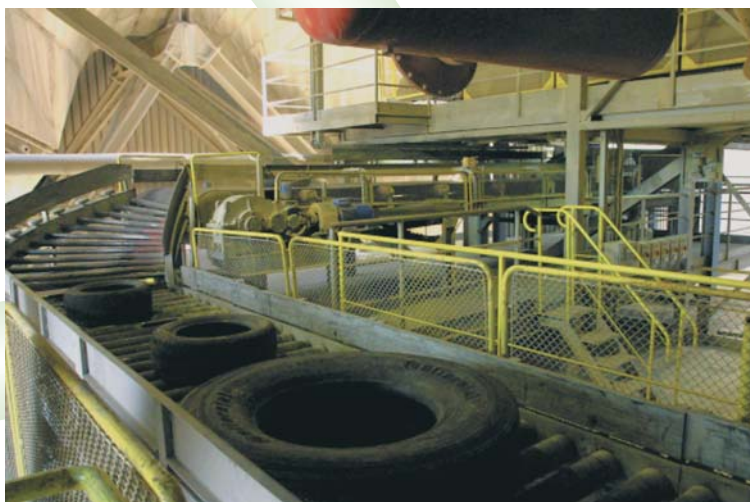
Instalacja podawania opon do pieca cementowego.
