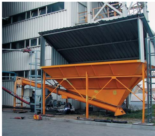
Instalacja do podawania paliwa alternatywnego.
