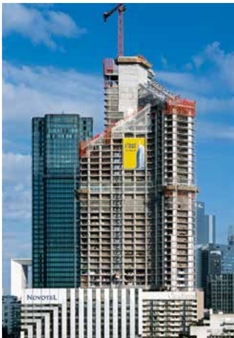
Rys. 12.2. Widok biurowca The First w Paryżu: a) w trakcie przebudowy (z lewej) b) po zakończeniu przebudowy [4] (po prawej)
