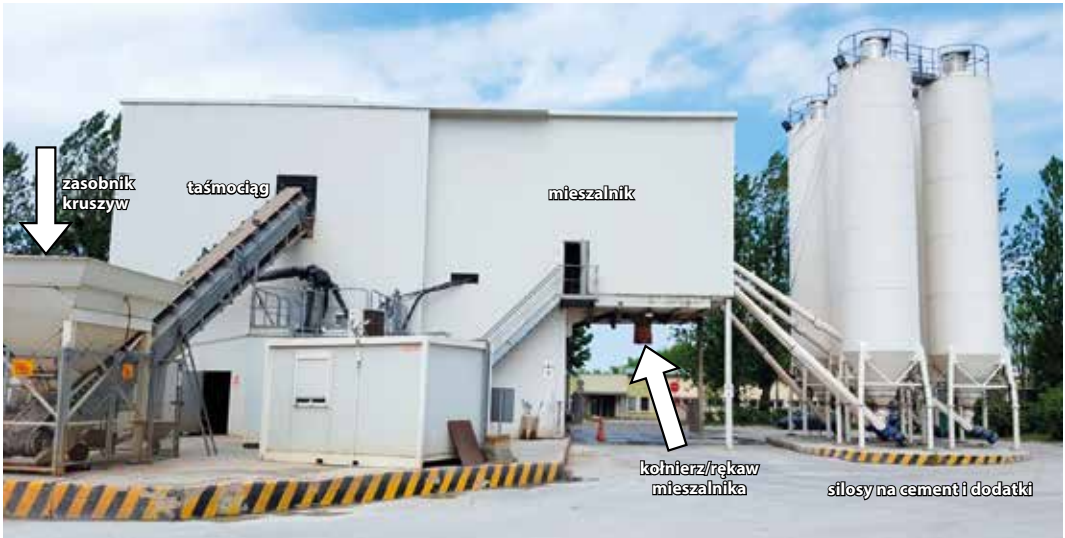
Rys. 3.1. Wytwórnia betonu (fot. SPC)
