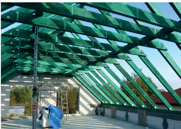
Fot. 5.3 – Żelbetowe słupki, zakotwione w wieńcach dachowym i stropowym odpowiadają za stabilność więźby dachowej
