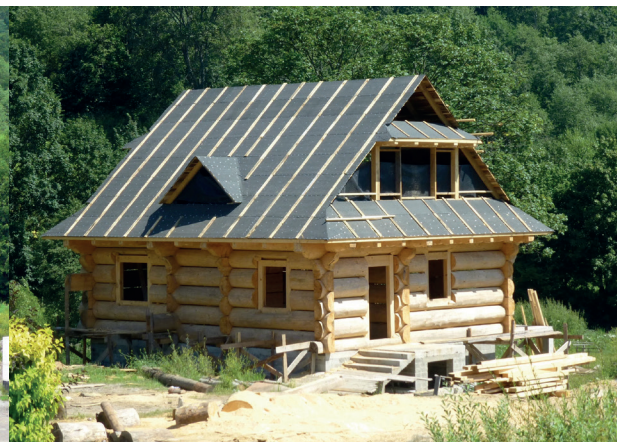
Fot. 2.2 – Przykryte dachem ściany z bali muszą najpierw pozbyć się wilgoci, zanim będzie można w nich zamontować okna i przystąpić do wykańczania domu
