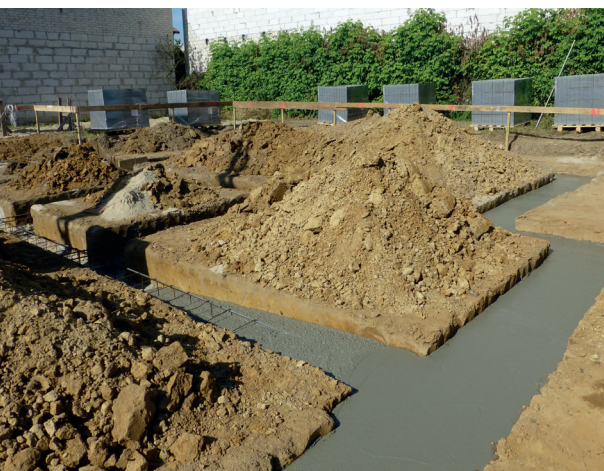
Fot. 3.1 – Jeśli warunki gruntowe na to pozwalają, zbrojone podłużnie ławy fundamentowe najczęściej betonuje się bezpośrednio w wykopach
