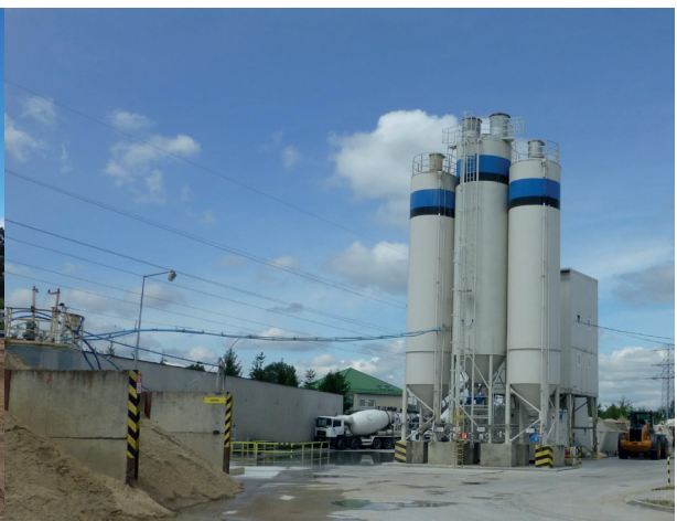
Fot. 1.2 – Do wykonania żelbetowych i betonowych elementów domu najlepiej zamawiać mieszankę betonową w sprawdzonej wytwórni
